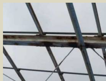
築20年 プール上屋の鉄骨にさびが発生
