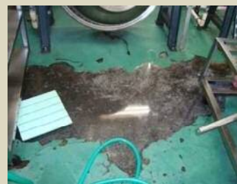
築34年 塗床の剥離
