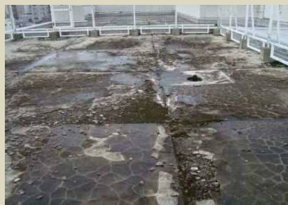
築27年 屋上コンクリートの劣化
