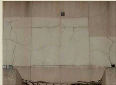
築30年 外壁のひび割れが発生
