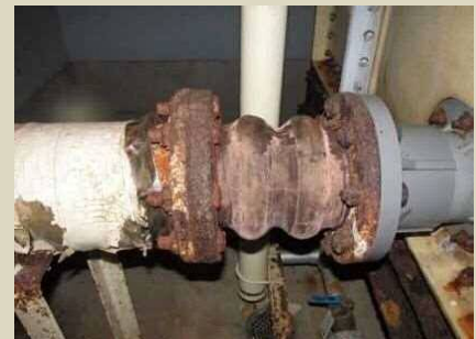
築32年 給水設備の老朽化
