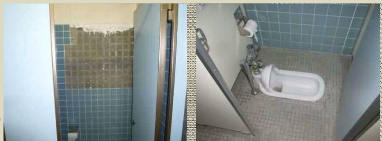
築43年 トイレの内部のタイルが剥落
