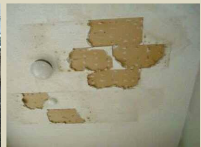
築41年 漏水による天井材の劣化
