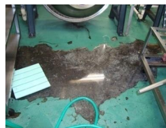
築 34 年 塗床の剥離
