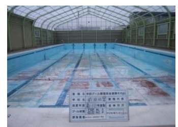
築16年 プール槽の塗装の劣化
