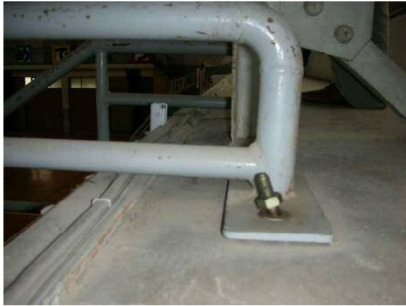
写真付 1.2.3 : 取付け部の緩みの例 17)
