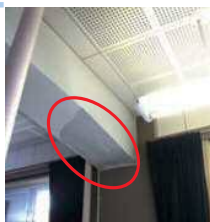
写真1. 教室梁下のモルタルの剥落
