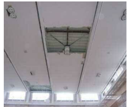
写真 1. 照明器具との取り付け部分の破損例
