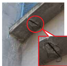
写真2. 軒裏のモルタルの剥落
