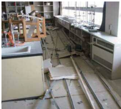
写真 2. 脱落した天井材
