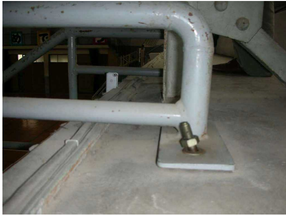
写真付 1.2.3 : 取付け部の緩みの例 17)
