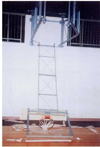
写真付 1.2.4 : フレーム接合部が外れて落下したバスケットゴールの例
