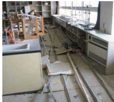
写真 2. 脱落した天井材
