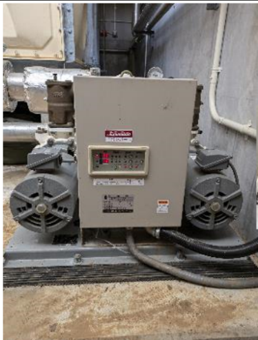
給水ポンプ2基側面
