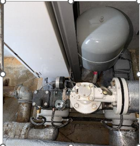
給水ポンプ2基上部とポンプ仕様
