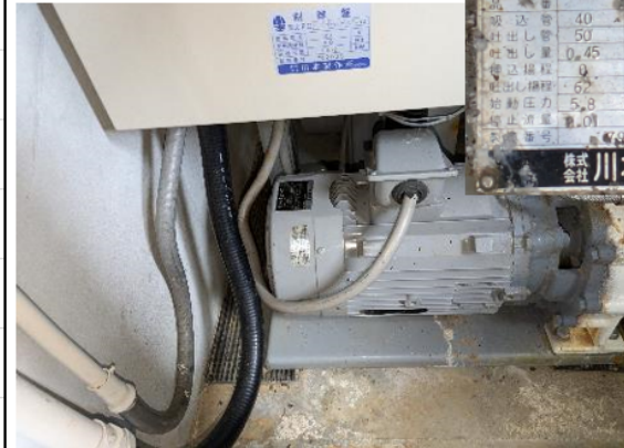
給水ポンプ側面
