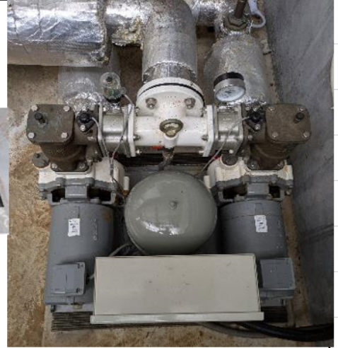
給水ポンプ2基上部とポンプ仕様
