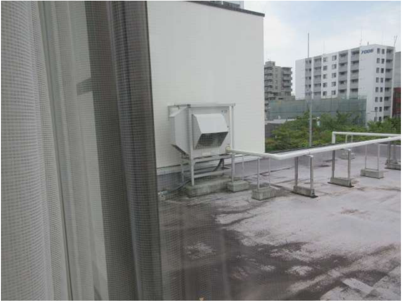
3 研バルコニー 和室エアコン室外機
