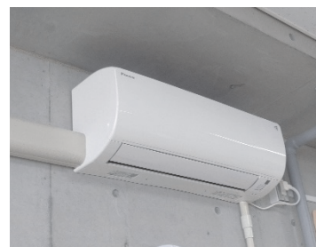
常設エアコン
