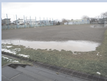
大きな水溜まりが発生
