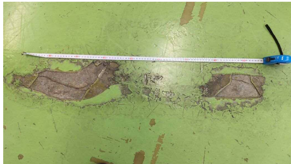
床塗装剥離箇所（活動室 1側 図示部分）
