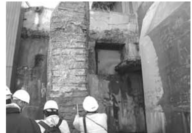
鉄骨が露出している外壁
