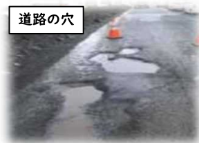
道路のひび割れ
