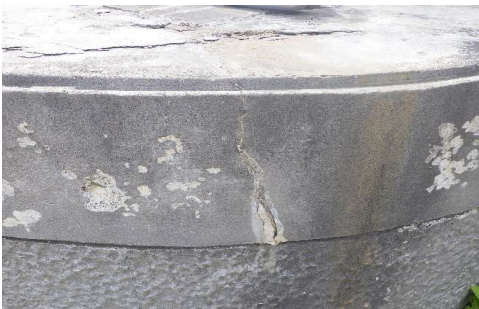
台座・壁面：ヒビ、盛り上がり変形
