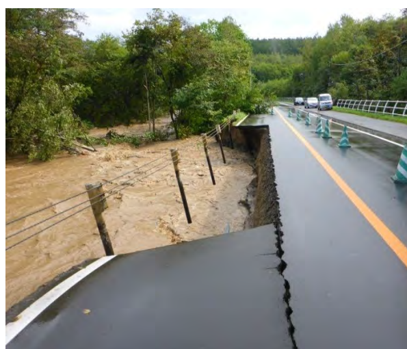
清田区有明（道路被害）
