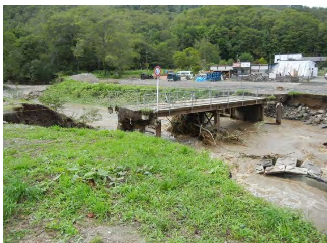
清田区有明（市有橋損壊）
