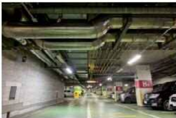
北一条地下駐車場の冷水導管幹線
