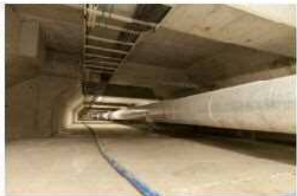
地下歩行空間地下ビット内の冷水導管幹線
