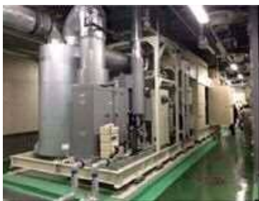
天然ガスコージェネレーション (地下4階)
