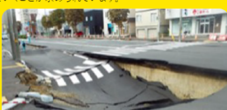
北海道胆振東部地震による道路陥没 ＜資料＞札幌市
