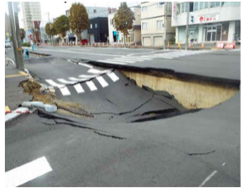
北海道胆振東部地震による道路陥没 ＜資料＞札幌市
