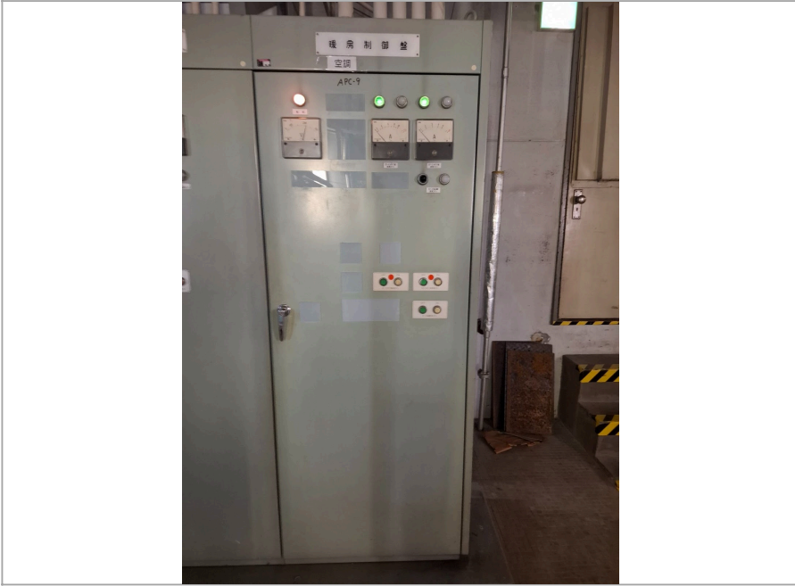
盤名称：暖房制御盤 APC-9 設置場所：地下1階ボイラー室 (盤外観)
