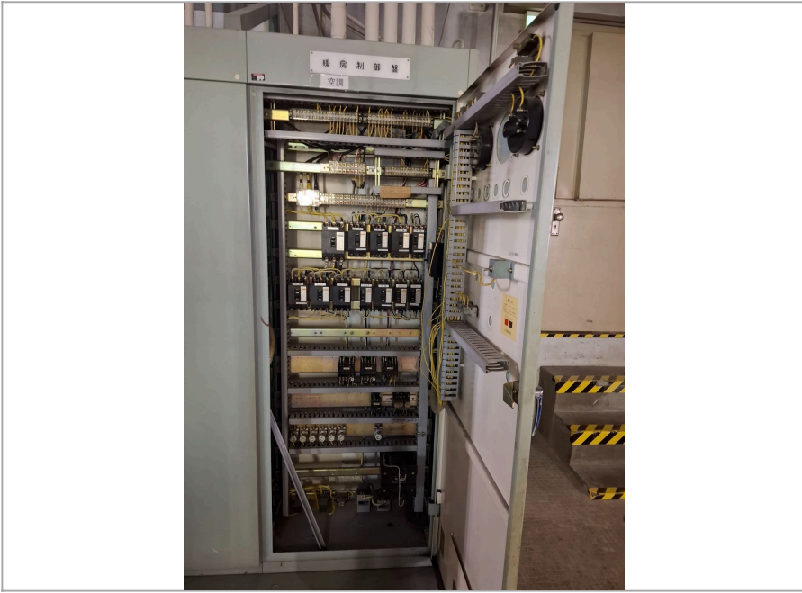
盤名称：暖房制御盤 APC-9 設置場所：地下1階ボイラー室 (盤内状況)
