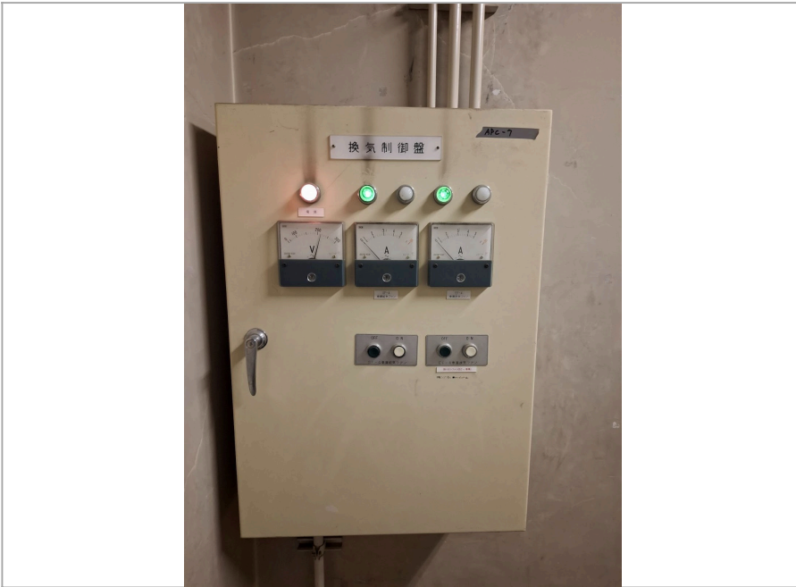
盤名称：B1車庫制御盤
