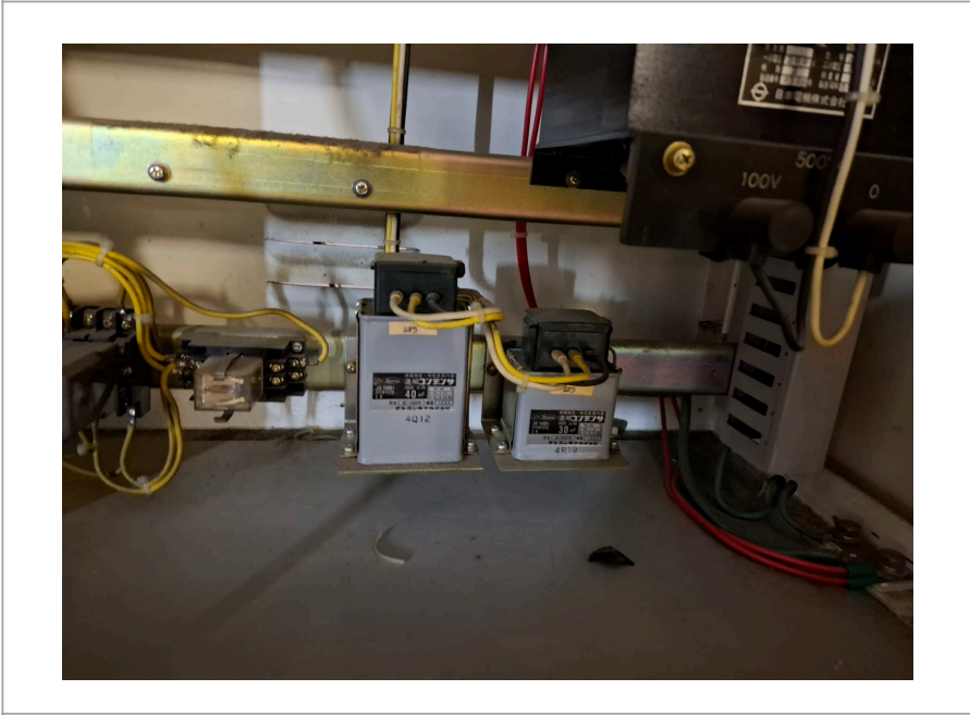
盤名称：暖房制御盤 APC-9 設置場所：地下1階ボイラー室 (対象コンデンサ)
