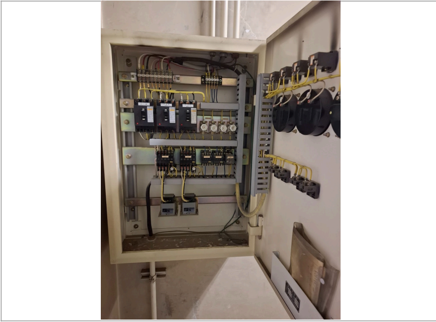
盤名称：B1車庫制御盤
