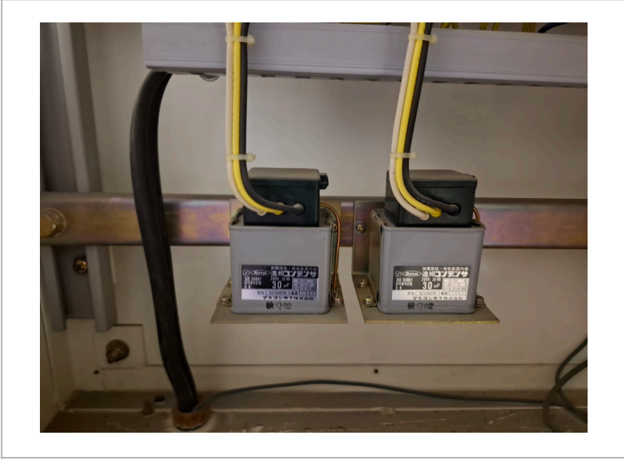
盤名称：B1車庫制御盤
