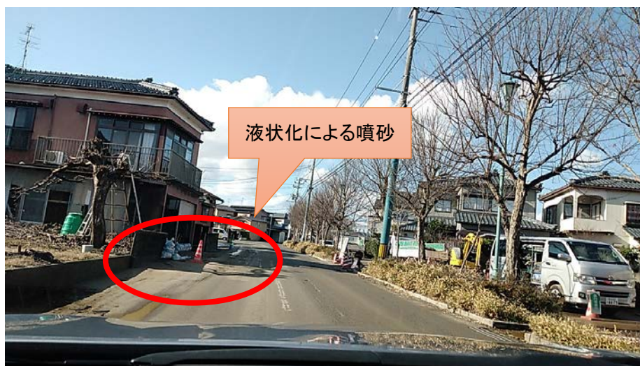
図 3-3-2 2024 年 1 月 4 日，新潟市西区善久，能登半島地震による液状化（噴砂）箇所
