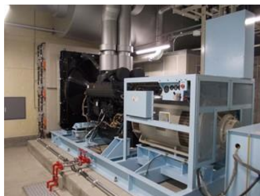
停電時にチ・カ・ホに電力を供給する非常用発電機
