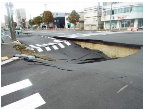
図2.3.6 北海道胆振東部地震における札幌市内の被害状況
