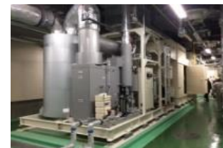
天然ガスCGS (創世エネルギーセンター)
