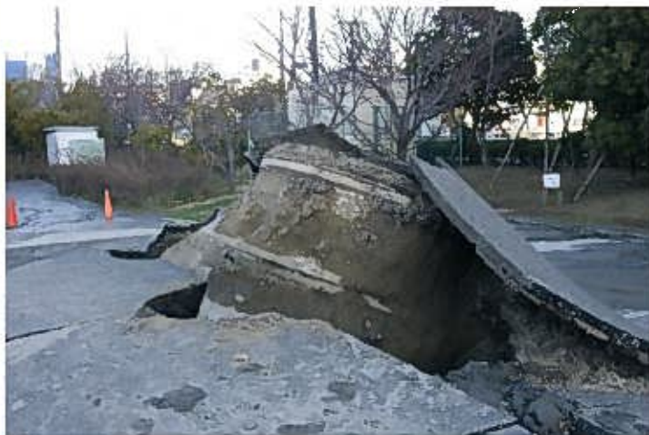
↑ 地面から飛び出したマンホール
