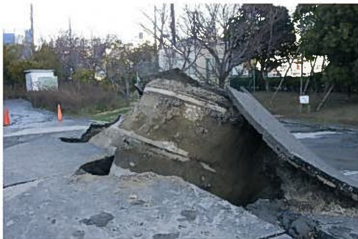
↑ 地面から飛び出したマンホール
