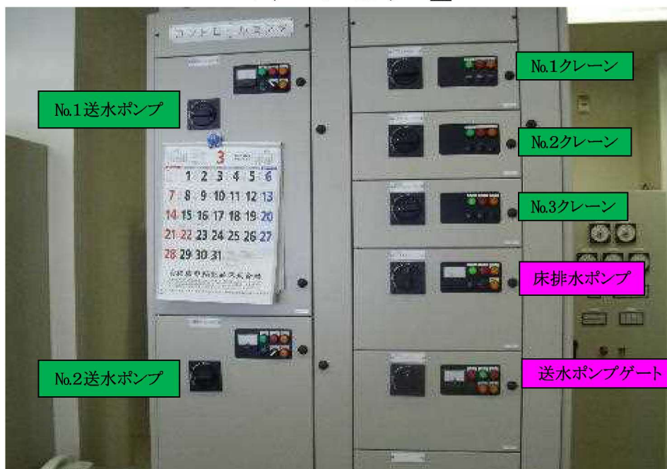
コントロールセンター盤
