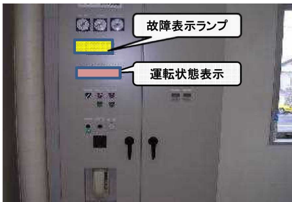
【(No.1)ロータリー除雪機制御盤】
