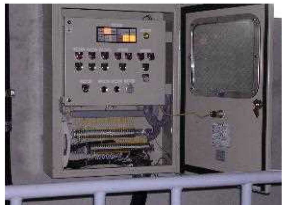
(No.2) 除雪機現場操作盤
