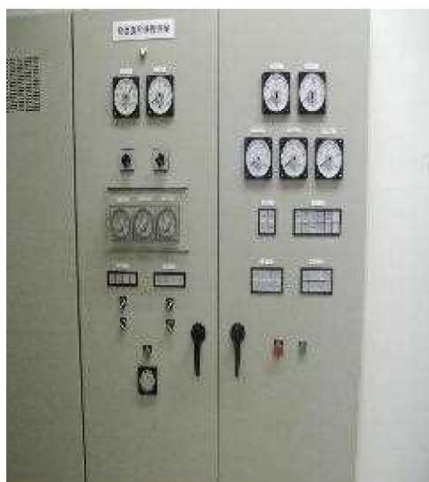
No.1投雪蓋制御盤
