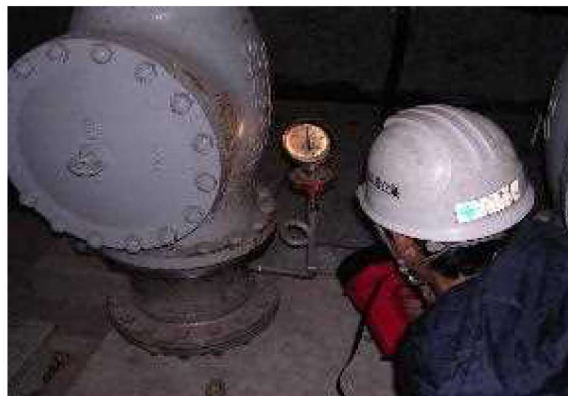
【送水ポンプ点検状況】
