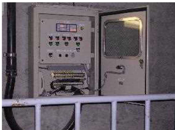
(No.1) 除雪機現場操作盤
