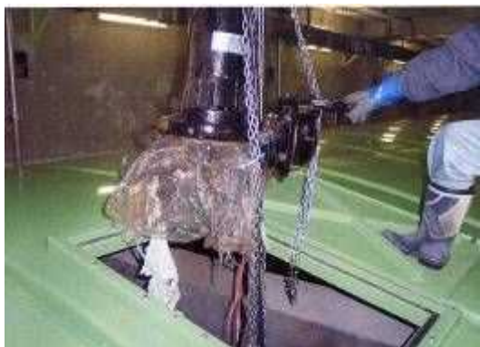
水中ポンプ ゴミ付着状況
