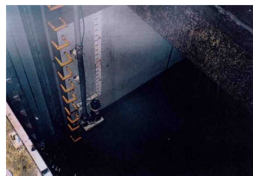
放水ポンプ設置状況
