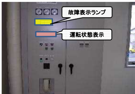
【(No.1)ロータリー除雪機制御盤】
