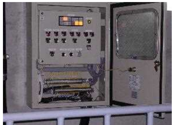
(No.2) 除雪機現場操作盤
