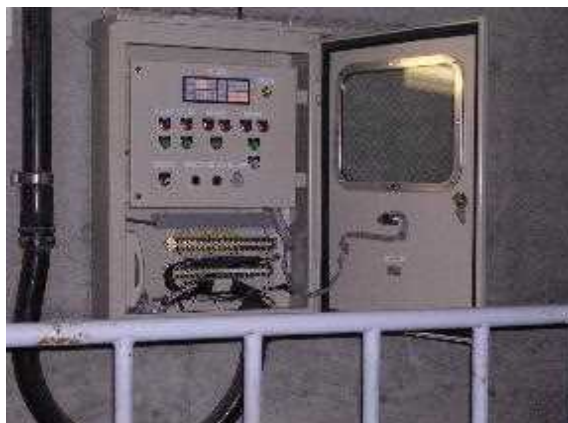
(No.1) 除雪機現場操作盤
