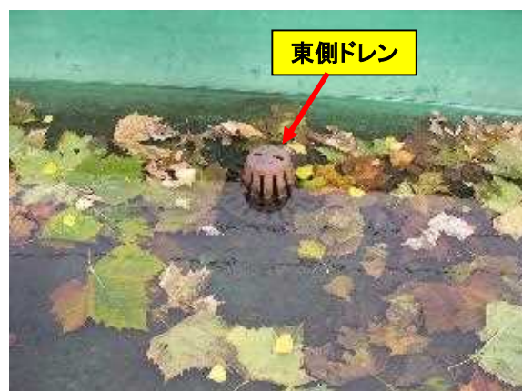
【屋上東側ルーフドレン清掃前】排水不良状況
