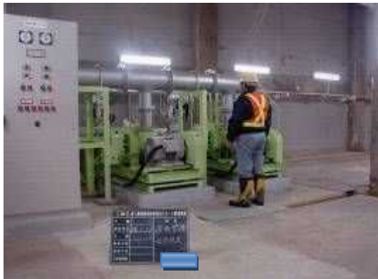
ブロー等機器運転状況確認
