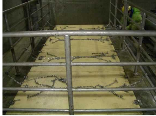
堰上げ後、転落防止蓋
