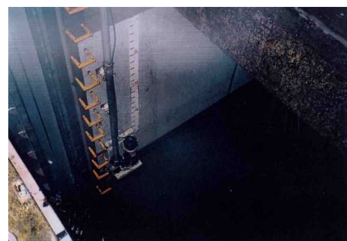
放水ポンプ設置状況
