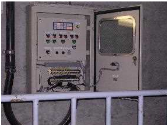
(No.1) 除雪機現場操作盤
