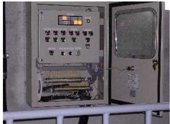
(No.2) 除雪機現場操作盤
