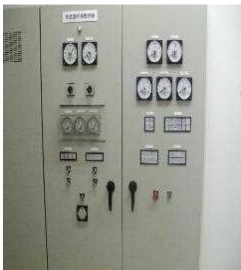
No.1投雪蓋制御盤
