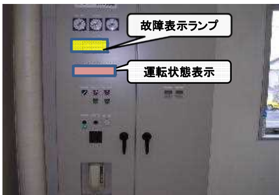
【(No.1)ロータリー除雪機制御盤】
