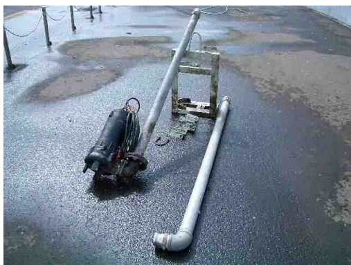
引上げ後の水中ポンプ
