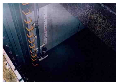
放水ポンプ設置状況
