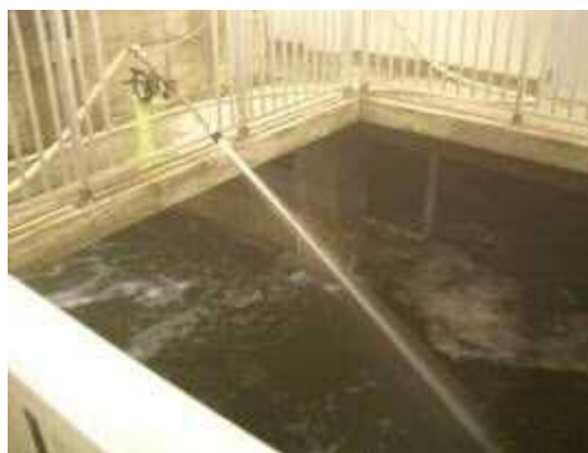
放水銃試運転
