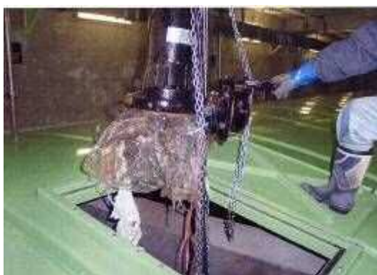
水中ポンプ ゴミ付着状況
