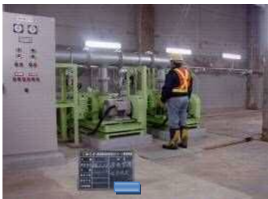
ブロー等機器運転状況確認
