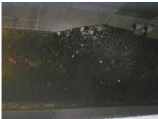
管内排水後の投雪口真下状況 No.1 投雪口下に土砂が堆積している。
