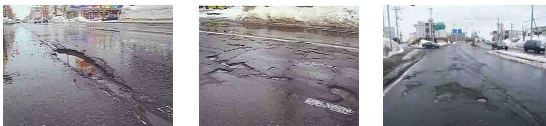
凍結融解等による春先の路面損傷状況(2011年撮影)
