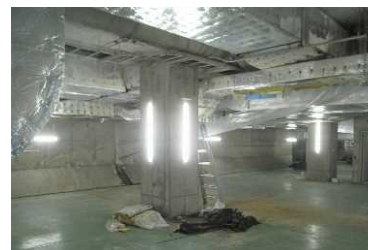
【換気ダクト】 保温材が腐食し落下 全面的な改修必要
