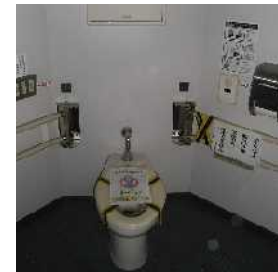
【便所】 配管・センサー異常 により使用中止
