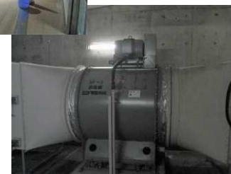
【送風機】 モーター異常による故障
