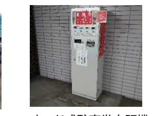
カード式駐車券自販機 (故障中)
