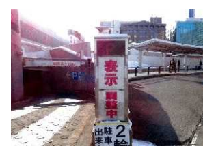
入口満空表示灯(故障中)
