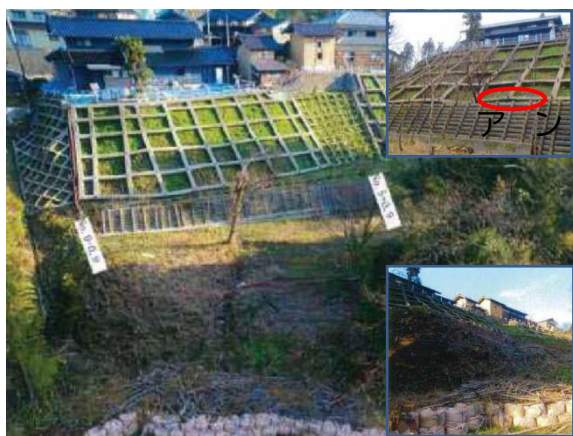
<対策実施前：アンカー浮上り、斜面崩壊>
