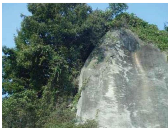
<対策実施前：モルタル吹付工の劣化>
