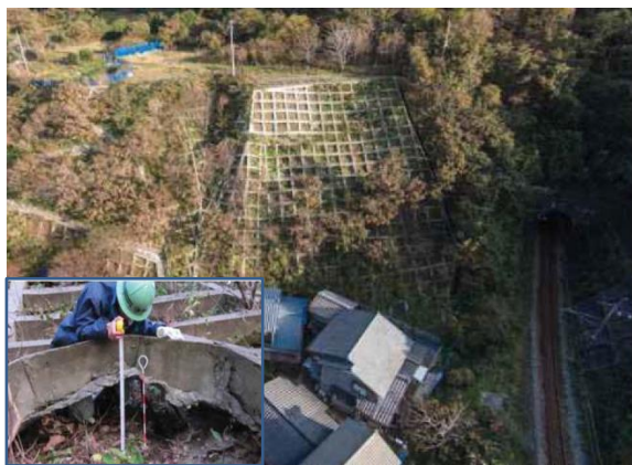
<対策実施前：のり枠と地山の密着不良等>
