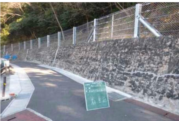
<対策実施前：落石防護擁壁表面クラック>
