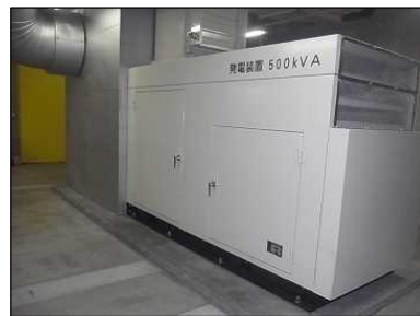
非常用発電機
