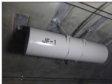
換気設備（ジェットファン）
