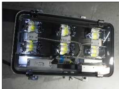
照明設備（LED）
