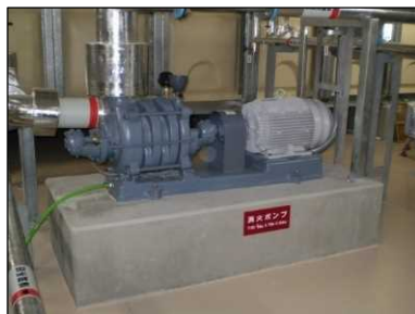
消火ポンプ設備
