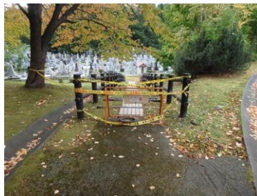
老朽化した階段
