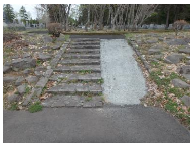
手すりのない階段
