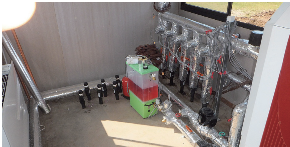
地中熱ヒートポンプシステム実施施設
