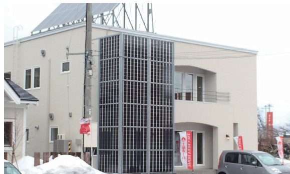
改修後の外観及び屋根・壁の両面受光型太陽電池
