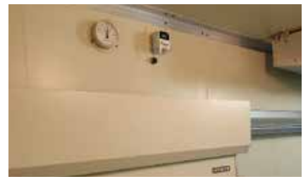
システム導入により設置された温度センサー(右側)
