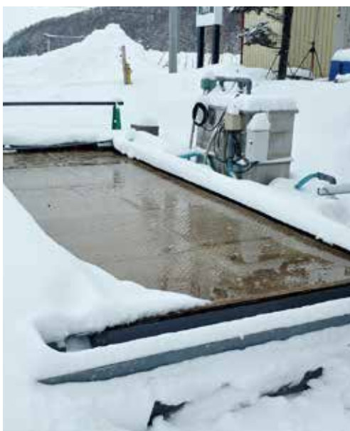
▲凍結防止剤(顆粒状)を使用した熱源に頼らない防積雪装置全景
