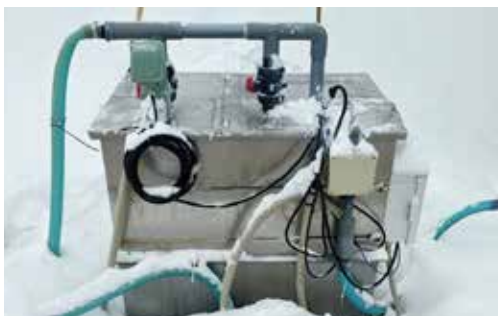
▲防積雪装置の回収タンク
