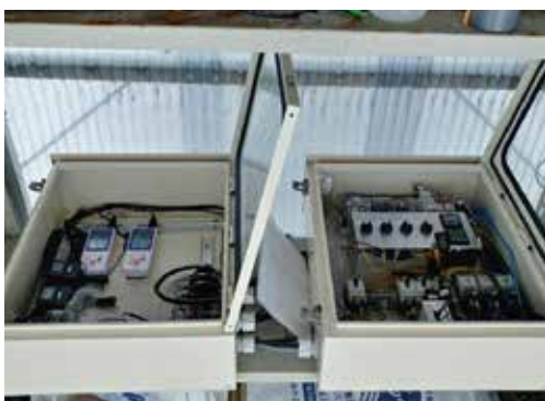
▲防積雪装置の制御盤類
