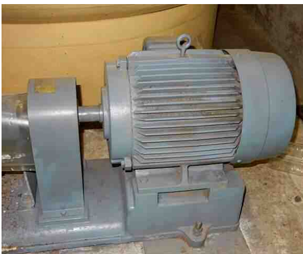
▼現状写真 2 及び銘板
