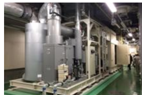
図 2-38 エネルギーセンター
