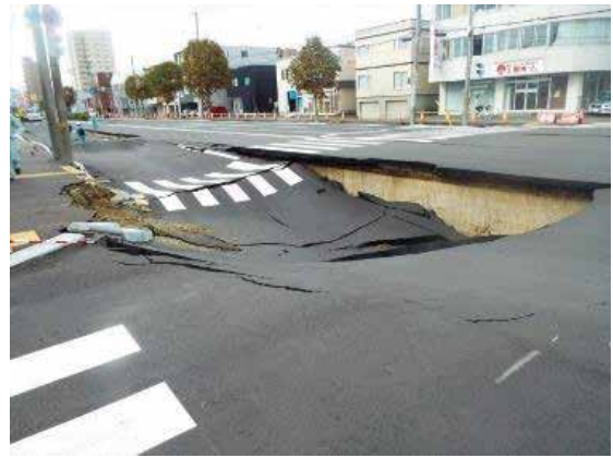
図 2-37 地震発生後の道路陥没のようす (平成30年北海道胆振東部地震) 資料：札幌市
