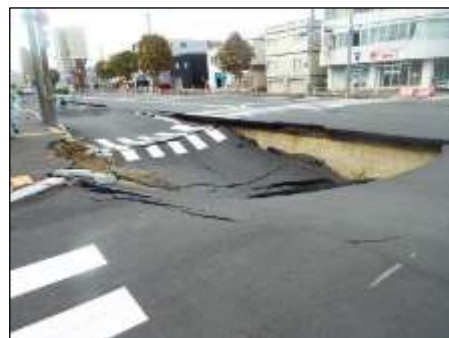
図 2-13 北海道胆振東部地震による被害
